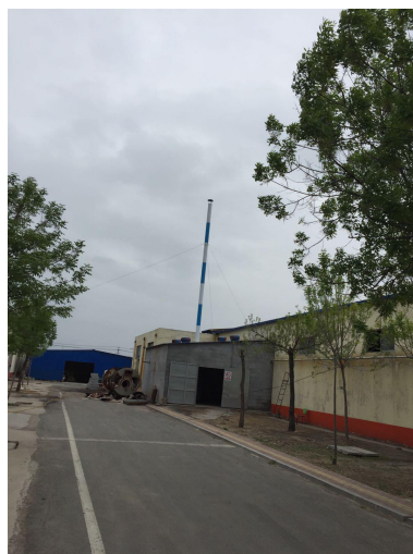
锅炉废气排气筒
