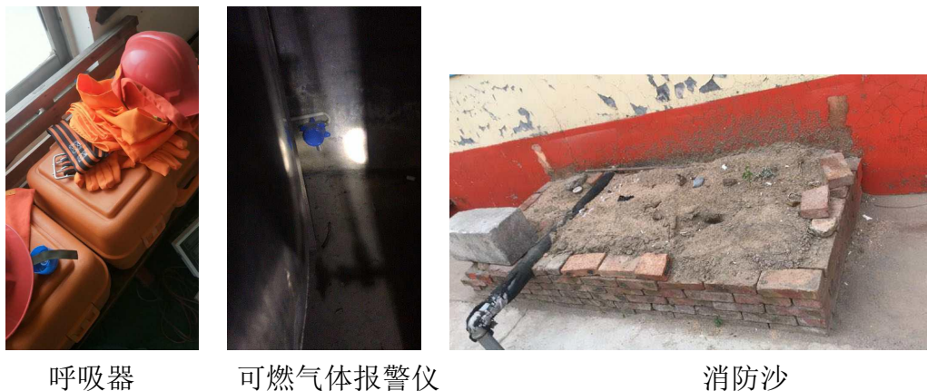
图 8.7-1 环境风险防范措施现场照片
