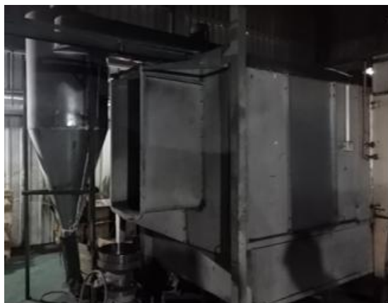
过滤棉粉尘净化器设施
