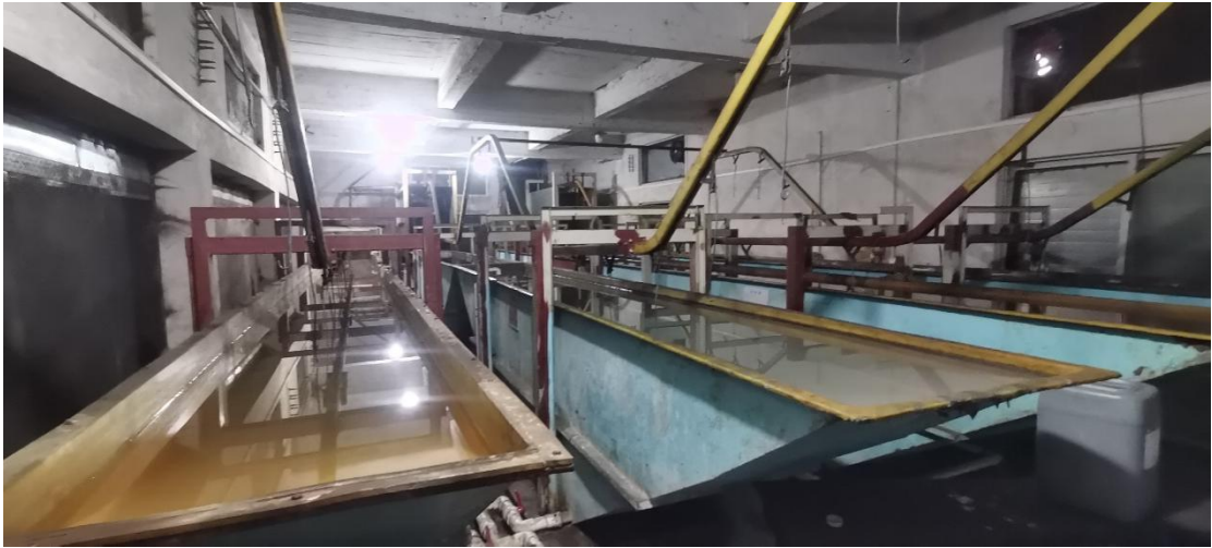
图 4.1-2 除油废水物化沉淀池图
