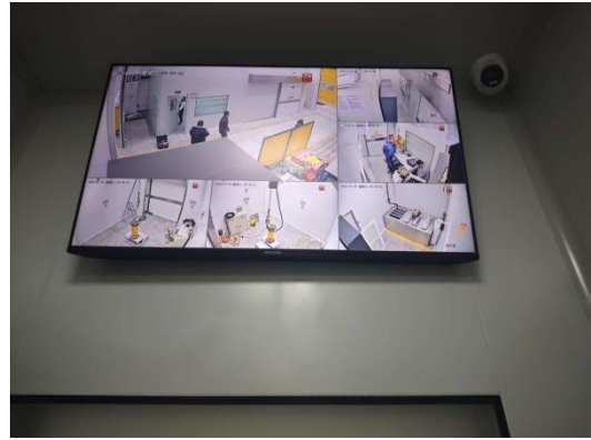
图 4 视频监控显示屏
