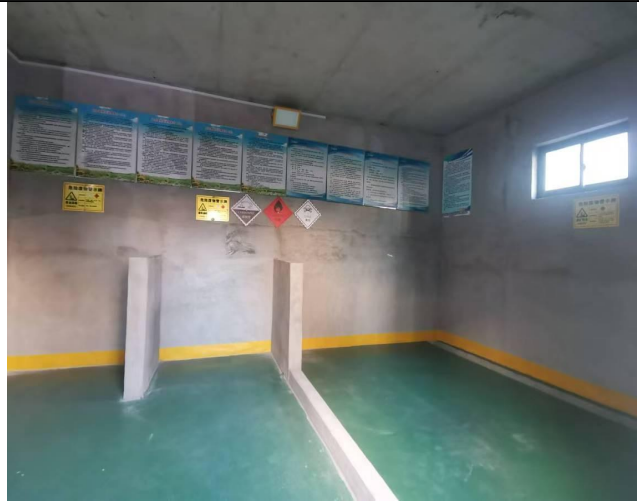
图17 危废暂存间内部
